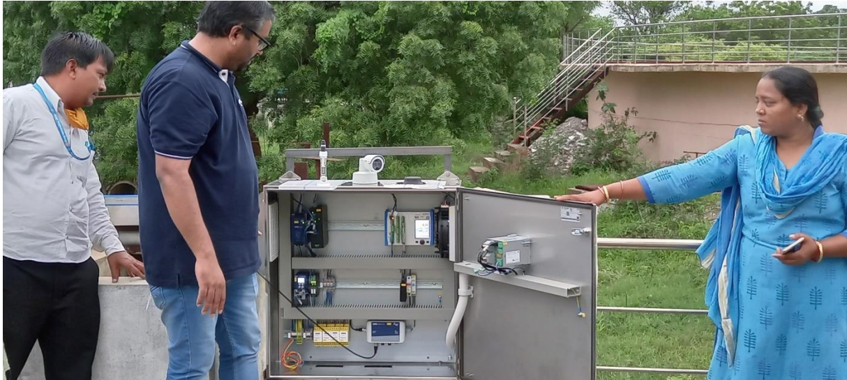
Abb1: Bild der Anlage in Solapur
