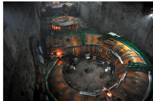
Überdimensionale Rohre im Inneren der Staumauer
